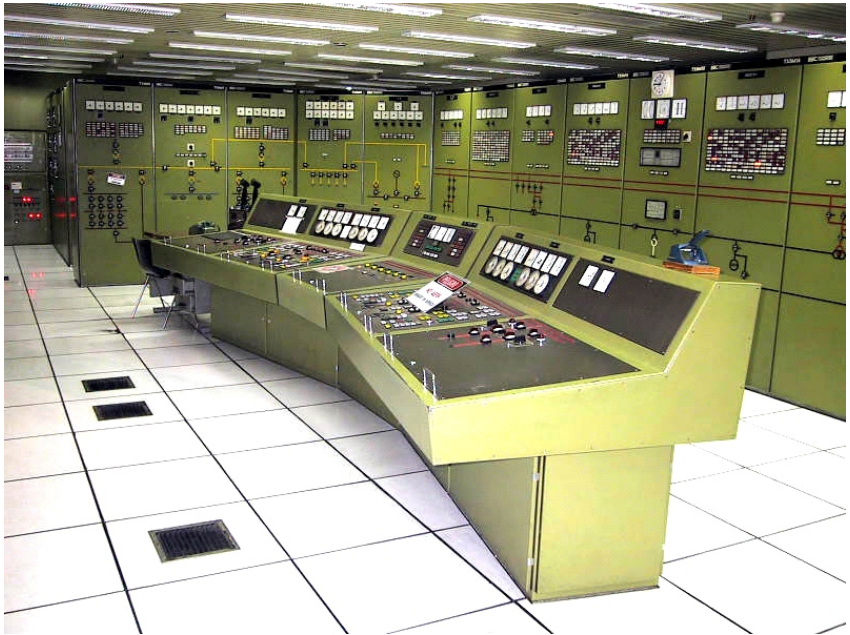
Figura 6. Sala de Comando
