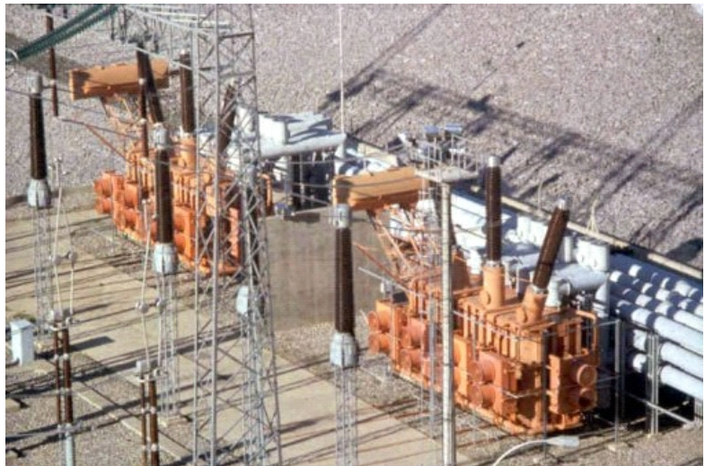
Figura 9. Playa de Transformadores
