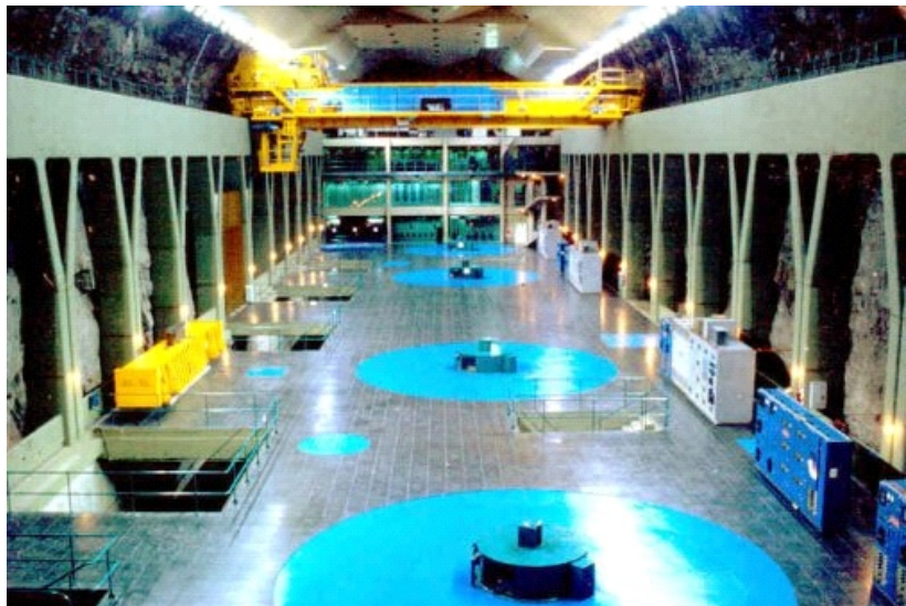
Figura 4. Sala de Máquinas en Caverna
